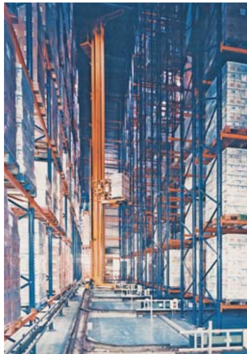
Sistema giro en curva, que permite a los transelevadores cambiar de pasillo. Fuente: Mecalux.
