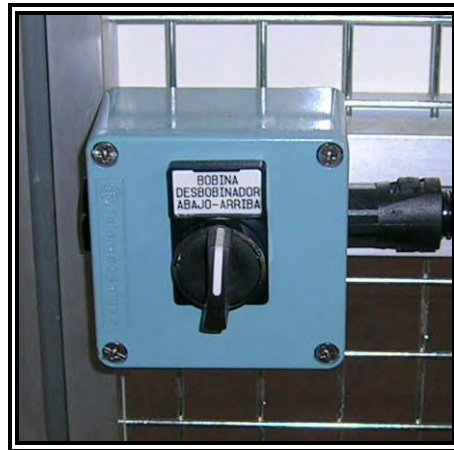
Figura 5-5-5 Caja de mando del elevador del desbobinador
