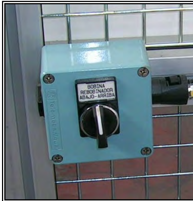
Figura 5-57 Caja de mando del elevador del bobinador
