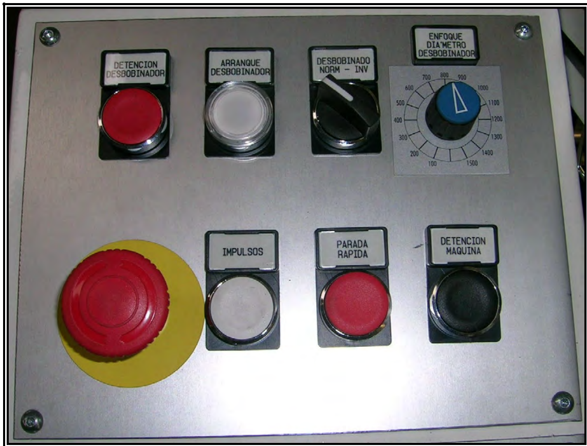
Figura 5-4 Panel de control del desbobinador
