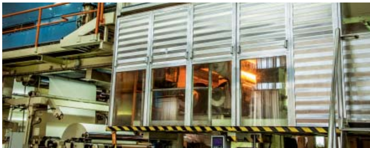
Instalación de encolado/ Paper-sizing system
